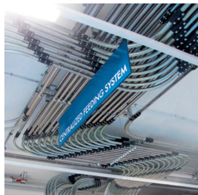
Installation example with antiwear bends. Esempio di installazione con curva antiusura.
