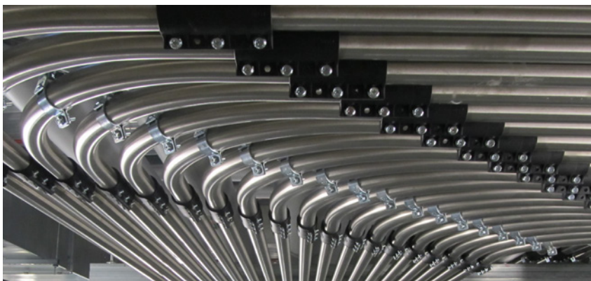
Installation example with stainless steel bends. Esempio di installazione con curva in acciaio inox.
