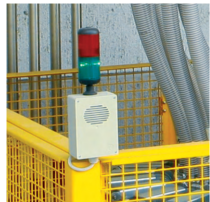
Acoustic alarm. Allarme acustico.
