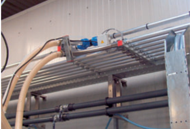
Aansluiting van de Piovan hopperloader op de seriële lijn en de centrale vacuümleiding.
