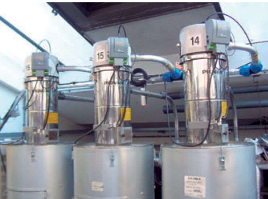
Hopperloaders op de droogtrechters op het bordes
