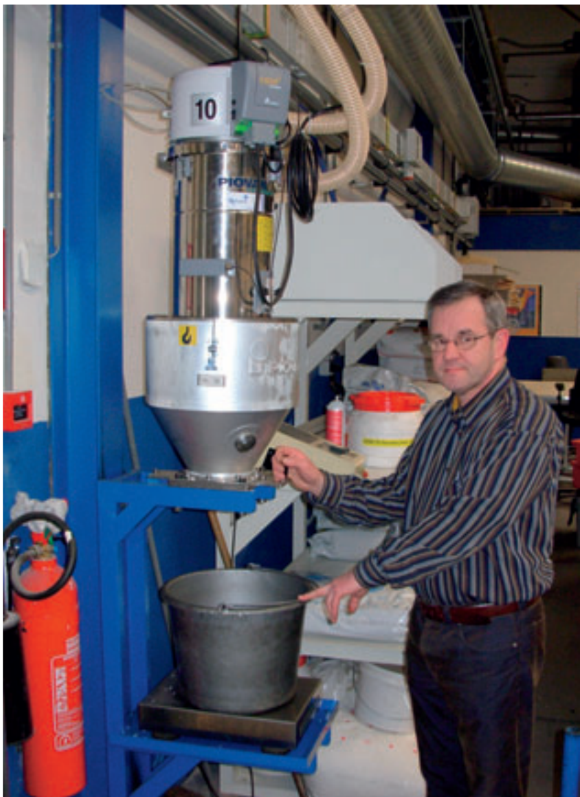
Aftappunt voor gedroogd materiaal voor het handmatig voeden van de kleinste spuitgietmachines.
