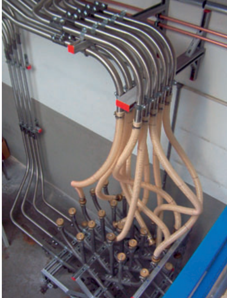
Bovenaanzicht van het Piovan koppelstation tussen de leidingen vanaf de machines en de drogers. Let op de speciaal gebogen leidingen.
